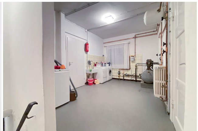
Hauswirtschaftsraum mit Grundwasserpumpe
