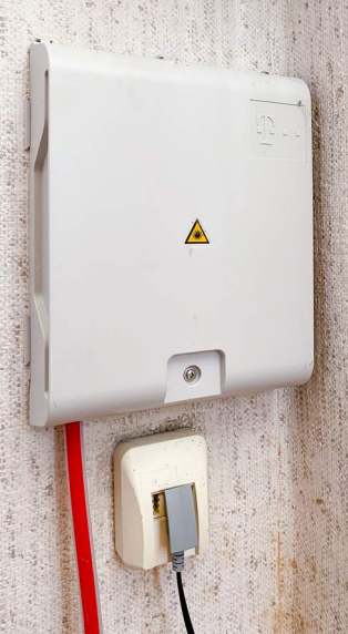
Glasfaseranschluss im Haus
